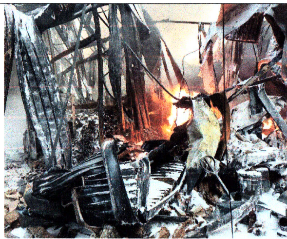
Imaginea nr. 8. Gradul de afectare termică a mărfurilor industriale și elementelor constructive din partea dreaptă a depozitului.
