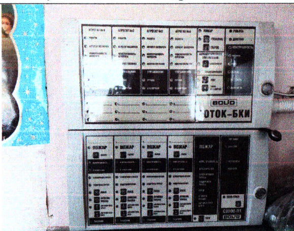
Imaginea nr. 22. Panou de recepție-control al instalațiilor de semnalizare și stingere a incendiilor din încăperea paznicului.
