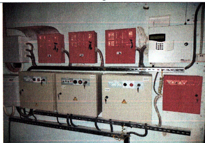
Imaginea nr. 21. Panou de recepție-control al instalației automate de stingere a incendiilor din stația de pompare.
