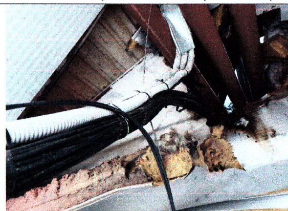
Imaginea nr. 12. Rețeaua electrică a depozitului, amenajată pe partea exterioră în jgheaburi metalice.
