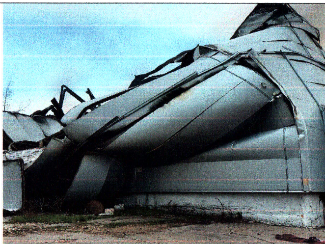
Imaginea nr. 13. Gradul de deformare a pereților depozitului.
