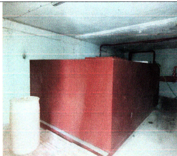
Imaginea nr. 20. Rezervorul de apă a instalației automate de stingere a incendiului.
